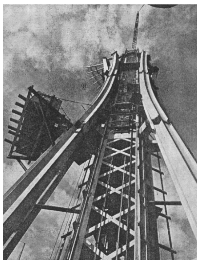
Rys. 4. Wznoszenie wieży Space Needle o wysokości 183 m w Seattle (USA). Główne elementy nośne stanowią belki dwuteowe zgięte płomieniowo [Welding Engineer 1965].
