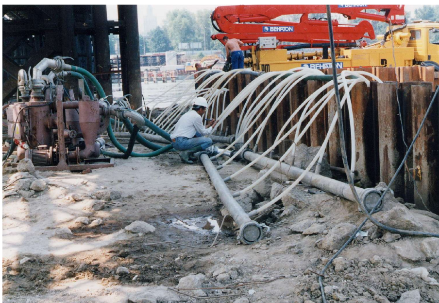
Rysunek 1.17: Instalacja chłodząca na fundamencie pylonu mostu Świętokrzyskiego - źródło [10]
