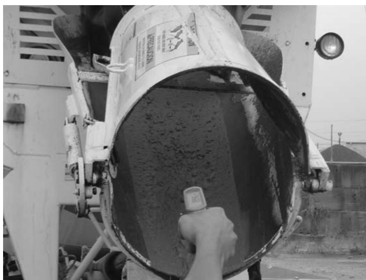
Rysunek 1.11: Pomiar temperatury za pomocą termometru na podczerwień [74]
