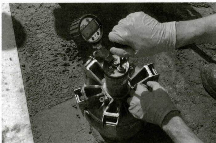
Fot. 2. Sposób prowadzenia pomiaru liczby SAM w warunkach polowych na miejscu budowy drogi ekspresowej
