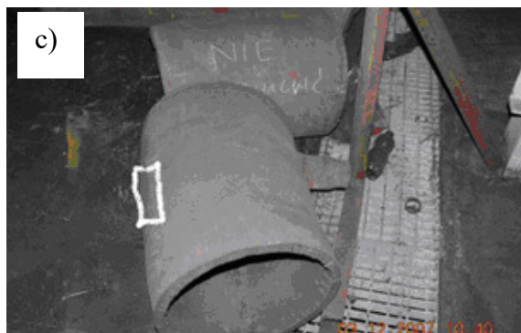
Rys. 1. Fragmenty instalacji energetycznych z zaznaczonymi miejscami pobrania próbek, od lewej: komora wlotowa 15HM, komora wlotowa 20H12M1F, kolana 13HMF
