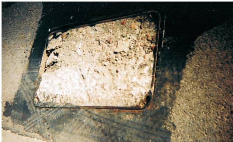
Fot. 12. Pokrywa żelbetowa zainstalowana w pasie ruchu kołowego kategorii KR2; widoczne bardzo duże ubytki betonu
