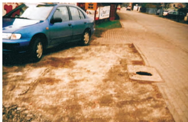
Fot. 9. Pokrywa żelbetowa o wym. 997 \times 597 \times 80 mm; widoczny brak wietrznika, pokrywa zlokalizowana w pasie jezdni o kategorii ruchu KR1
