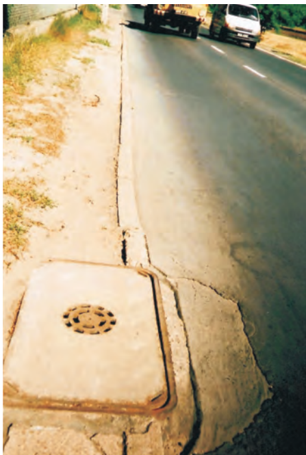
Fot. 3. Żelbetowa pokrywa z oprawą żeliwną w zwieńczeniu studni w pasie jezdni o kategorii ruchu KR2 – widoczne pęknięcia, zarwania fragmentu pasa jezdni oraz duże luzy od 15 do 20 mm pomiędzy ramą żeliwną zwieńczenia i oprawą żeliwną pokrywy; brak jakichkolwiek oznaczeń pokrywy oraz znaku budowlanego
