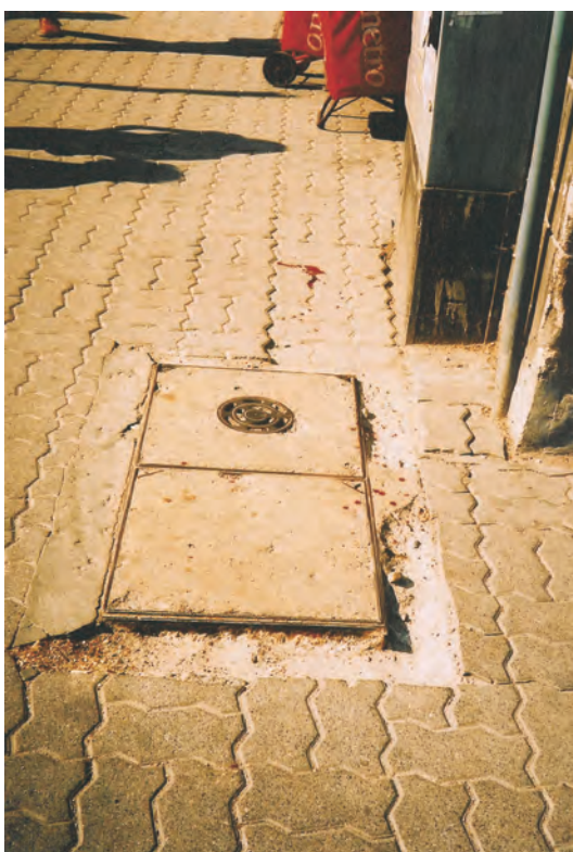
Fot. 17. Błędna instalacja zwiercenia powyżej poziomu chodnika; na skutek potknięcia został poszkodowany pieszy, widoczne ślady krwi
