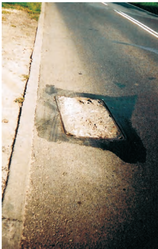
Fot. 13. Pokrywa żelbetowa zainstalowana pasie ruchu kołowego kategorii KR2; widoczny duży luz całkowity
