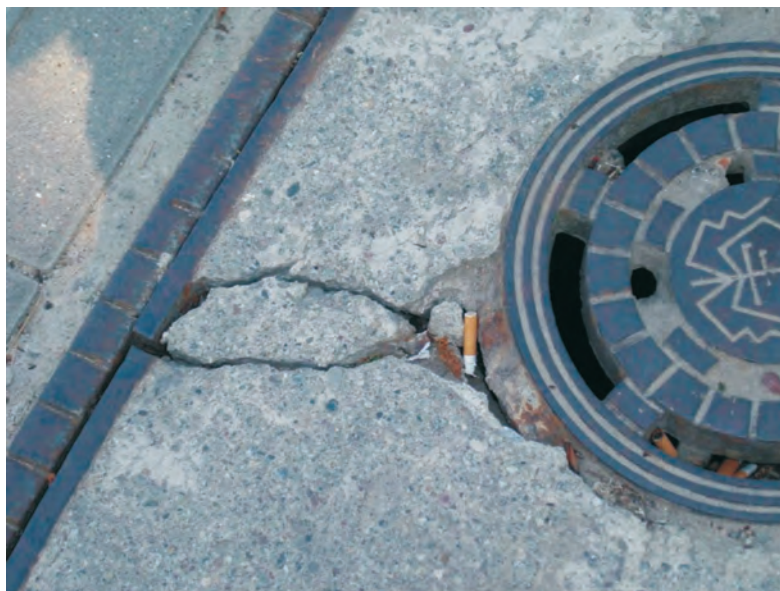
Fot. 18. Widoczne pęknięcie oprawy żeliwnej oraz spękanie betonu w pokrywie
