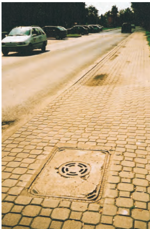
Fot. 5. Uszkodzona żelbetowa pokrywa z wietrznikiem \phi 330 mm; widoczne pęknięcia i ubytki betonu na całej grubości pokrywy
