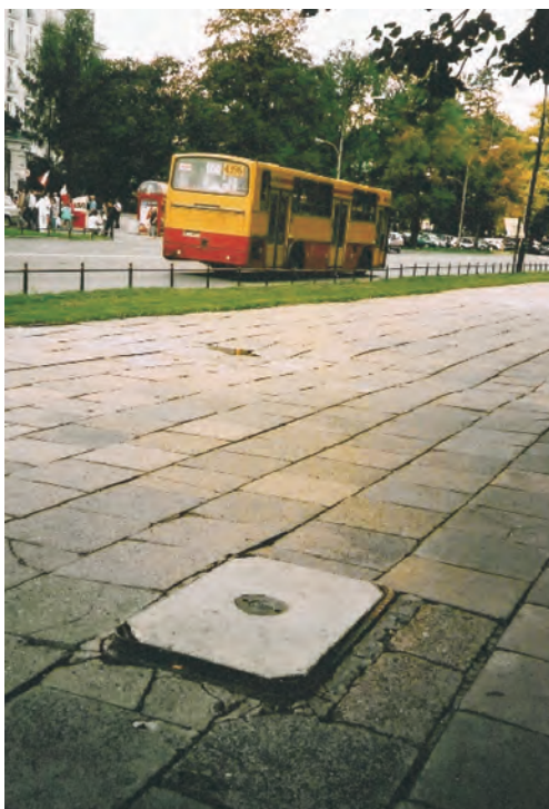
Fot. 6. Uszkodzona pokrywa z wietrznikiem w zwieńczeniu żeliwnym wystaje ponad 60 mm z ramy żeliwnej zwieńczenia; widoczne rysy na powierzchni i ubytki betonu
