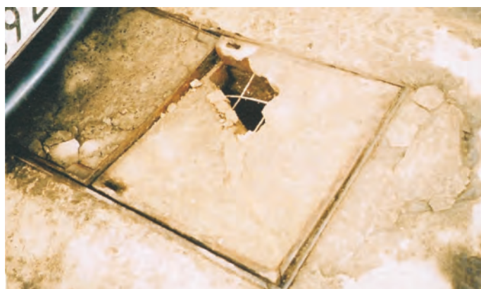
Fot. 15. Pokrywy żelbetowe o wym. 485 × 485 × 60 mm; widoczne nieprawidłowości montażu i zniszczenia betonu w stopniu dyskwalifikującym pokrywy
