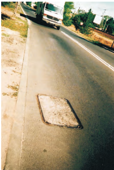
Fot. 4. Żelbetowa pokrywa pełna z oprawą żeliwną wystaje ponad 10 mm nad ramą żeliwną zwieńczenia; w zbliżeniu widoczne spękania na powierzchni oraz ubytki betonu na głębokości do 25 mm, brak jakiegokolwiek oznakowania pokrywy (pas jezdni kategorii ruchu KR2)
